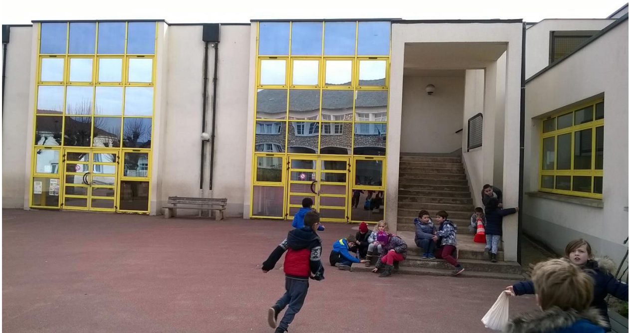
C'est le bâtiment moderne avant les travaux. Les fenêtres étaient jaunes. Les bancs étaient en bois.
